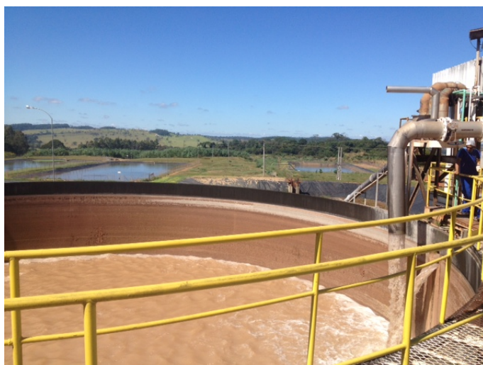
Figura 3.5 - Tanque de equalização
